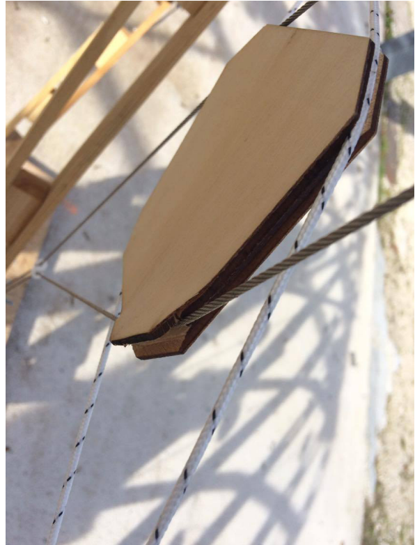
Après deux semaines, certaines pièces sont fragilisées du à la tension dans les câbles de contreventement (surtout au niveau des câbles en acier)
